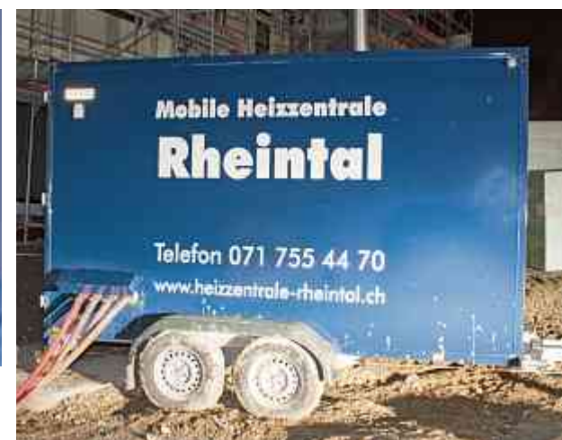
Die sehr bewährte mobile Heizzentrale.
