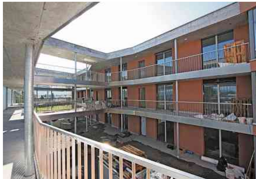
Das Atrium bietet den Hausbewohnerinnen und -bewohnern eine besondere Möglichkeit für das gesellschaftliche Zusammenleben.
