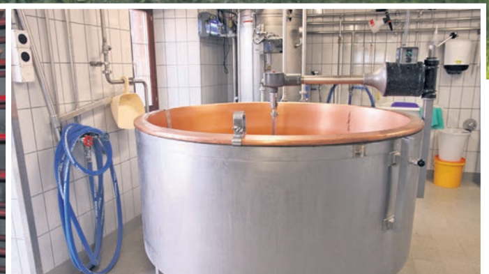
Das neue Käsekessi, hinten der neue Dampfkessel mit automatischer Wasserbespeisung. Bilder: mia
